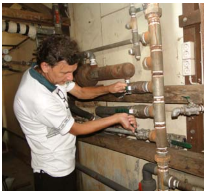
Werkzaamheden en hoog nodige reparaties bij de stoom leidingen voor de wasmachines en drogers.
