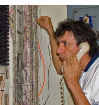
Af en toe ook eens één van de vele interne telefoon verbindingen repareren.
